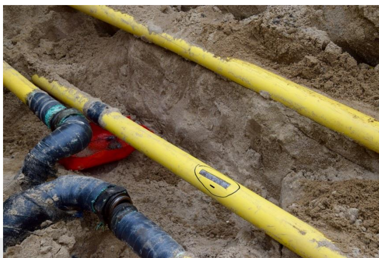
Foto: voorbeeld leidingwerk tank
